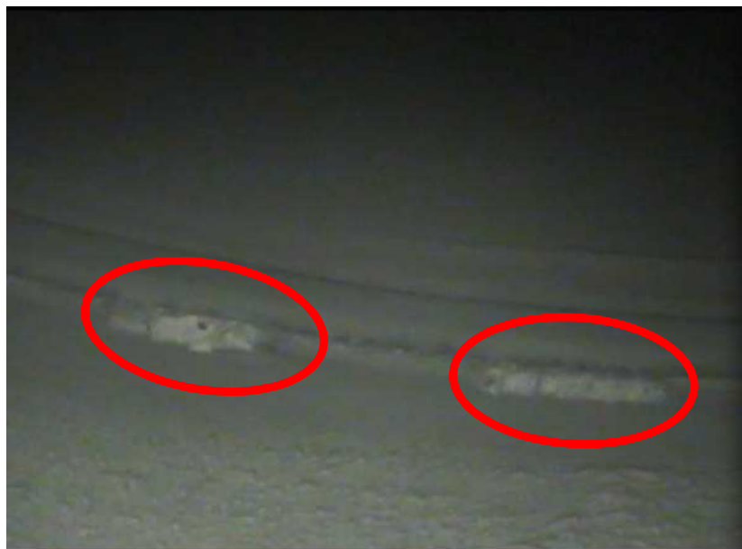
給水内管裏当金部点検結果（例） （B - S G：損傷なし）
