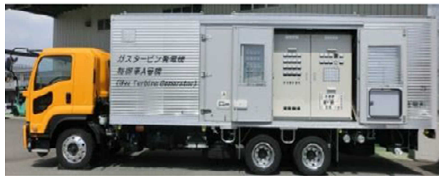
ガスタービン発電機
