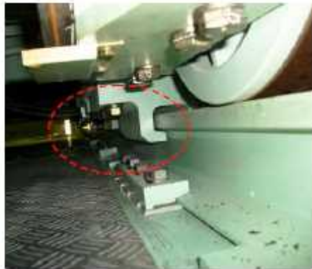
燃料交換機（トロリ）転倒防止装置
