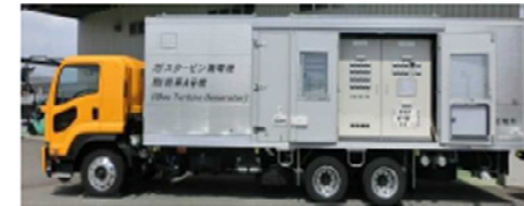
ガスタービン発電機
