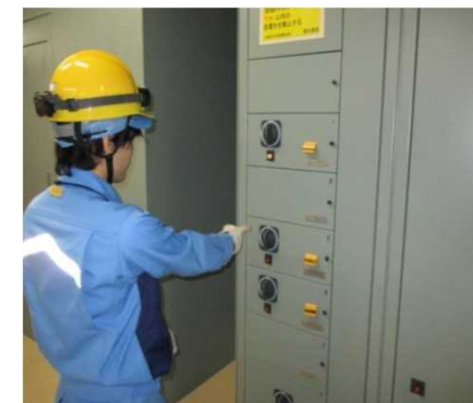
不要負荷切離し(作業イメージ) (中央制御室外遮断器)
