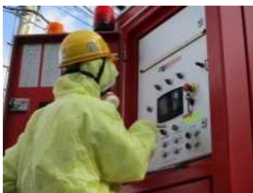
ポンプの起動
