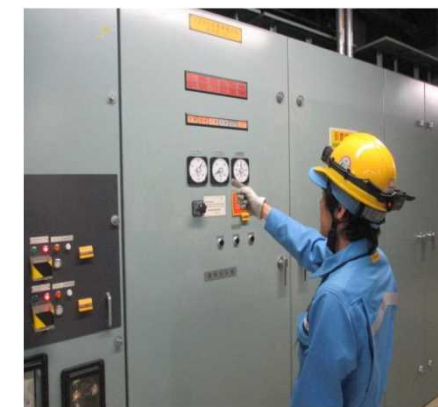
125V代替充電器の受電確認
