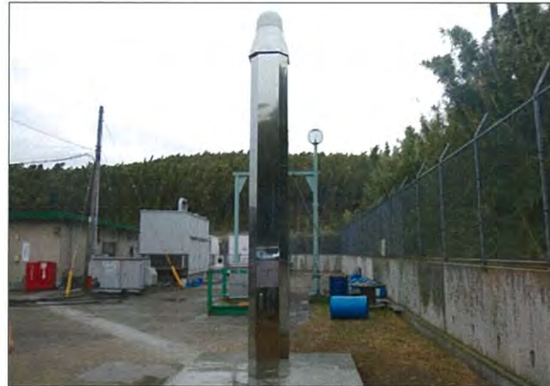
竹島の機器設置状況
