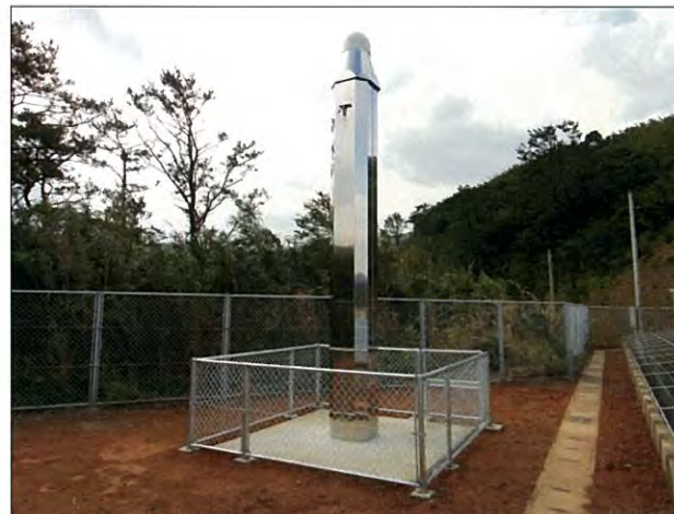
黒島の機器設置状況
