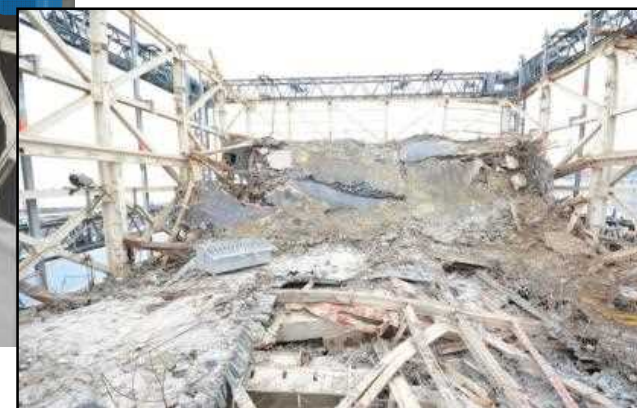
崩落屋根の状況
