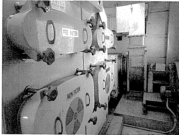
写真-1 排風機 外観
