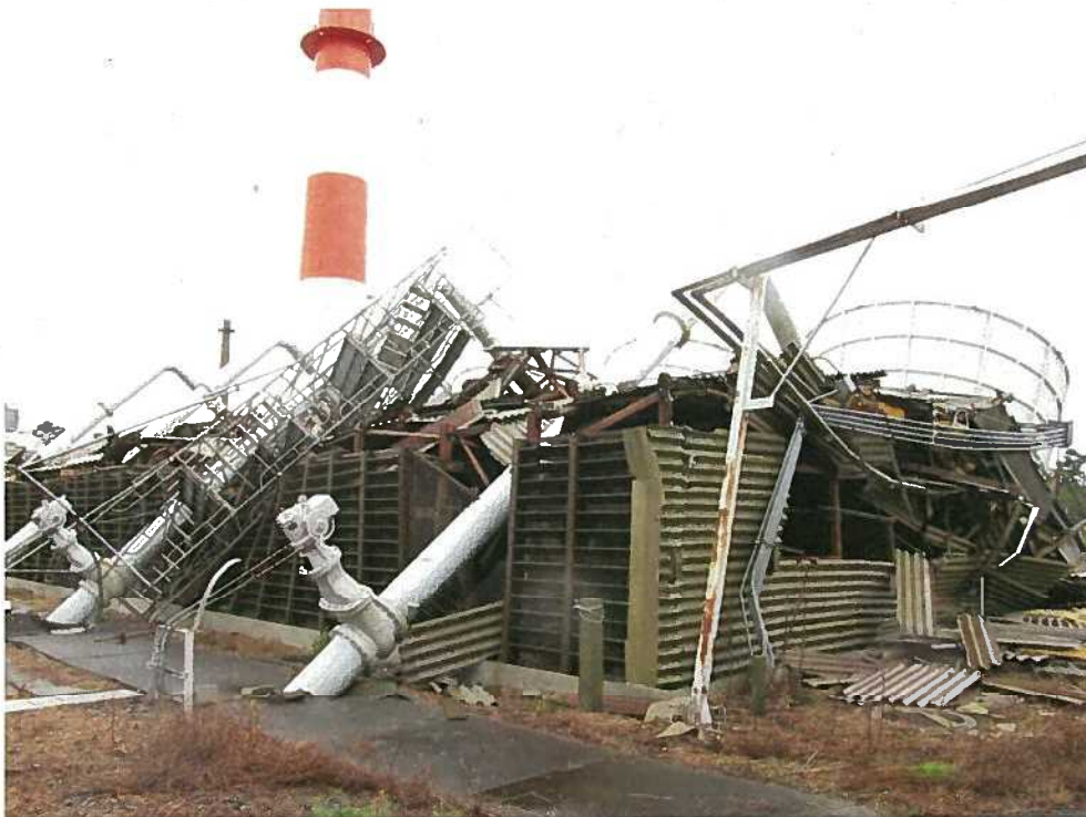
写真② 倒壊後（令和元年9月9日撮影）
