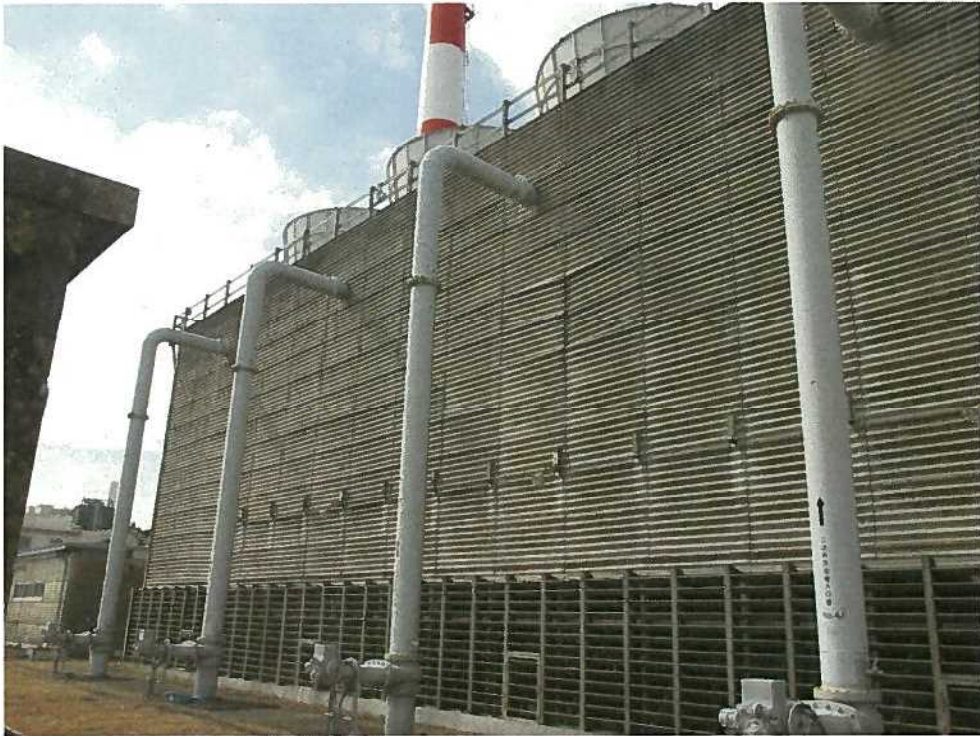
写真① 倒壊前（平成30年2月16日撮影）
