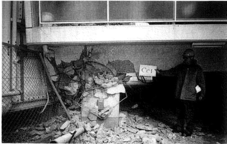
(1階柱の破壊状況)
