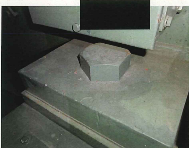
発電機本体基礎ボルト①
