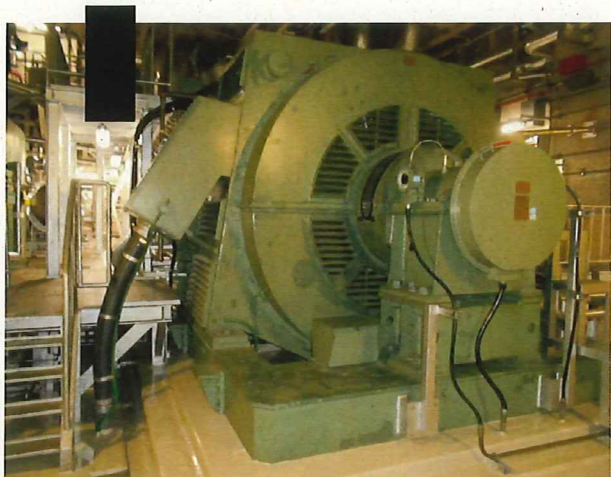
発電機全体外観
