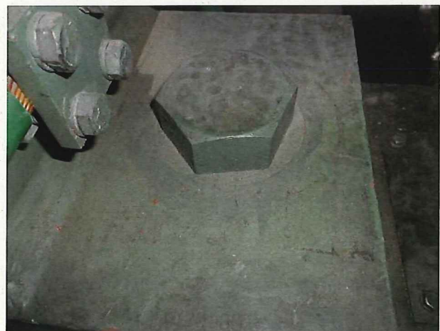
発電機本体基礎ボルト②
