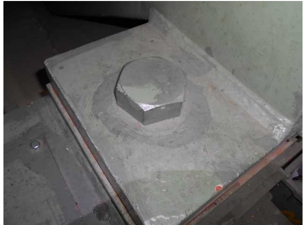
発電機本体基礎ボルト④
