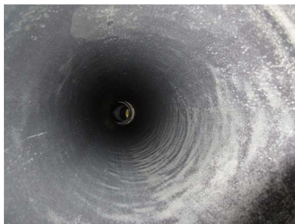
L側排気管 (内部)
