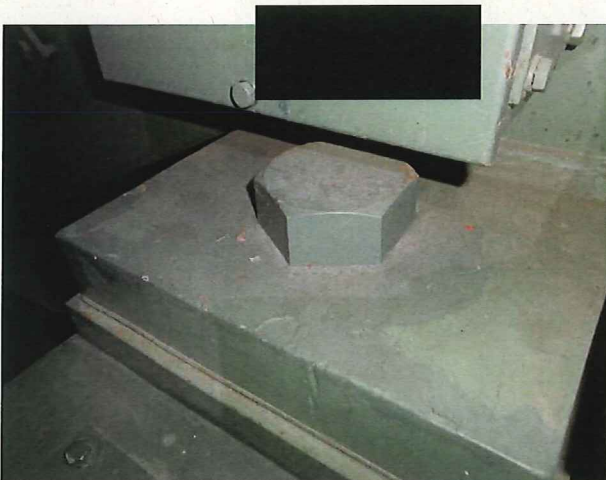
発電機本体基礎ボルト①
