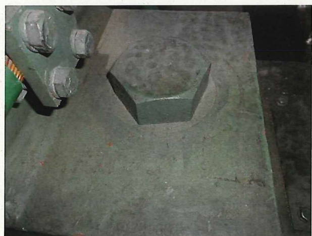
発電機本体基礎ボルト②
