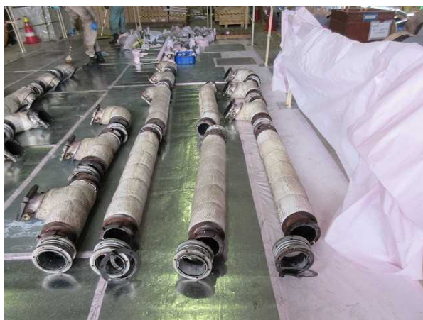
R側排気管・伸縮継手
