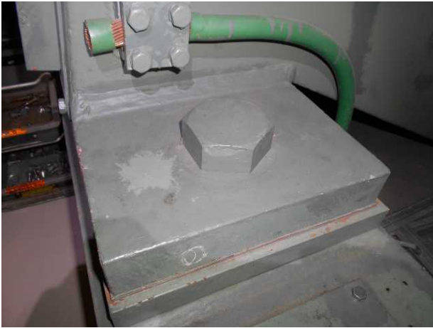
発電機本体基礎ボルト
