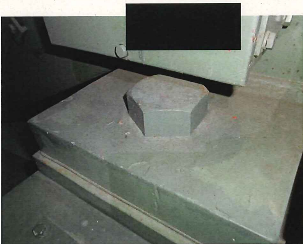
発電機本体基礎ボルト①
