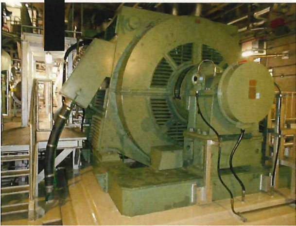
発電機全体外観
