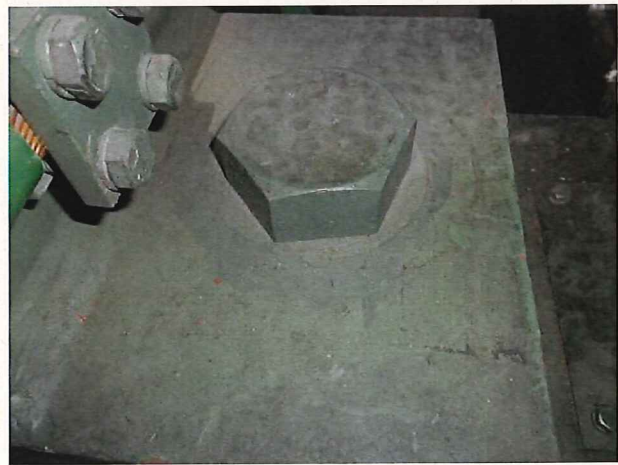
発電機本体基礎ボルト②
