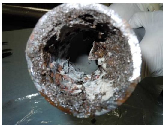
断面写真 2. 横引き配管の切断部位
