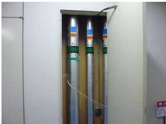
写真 1. 漏水が確認されたパイプシャフト (SPRC3 棟 2F 廊下)
