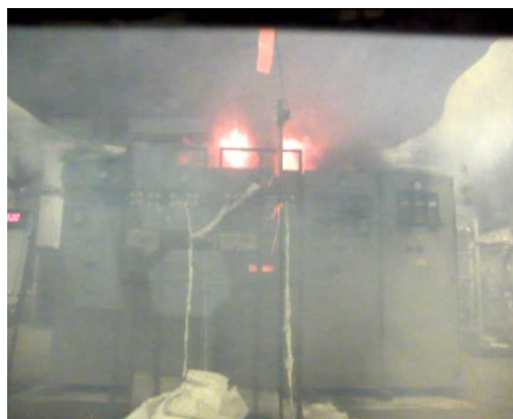
図 2. 2. 2-2 高圧電源盤の延焼試験 (参5)
