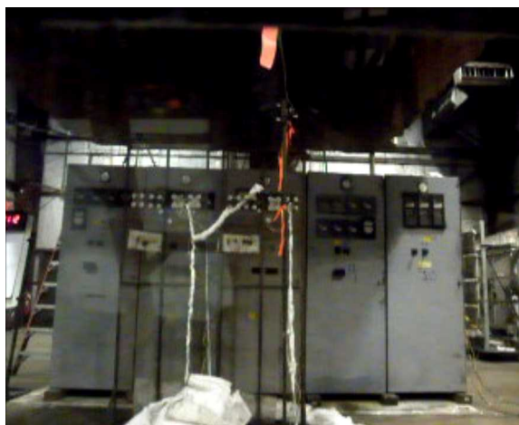
図 2. 2. 2-1 試験前の高圧電源盤 (参5)
