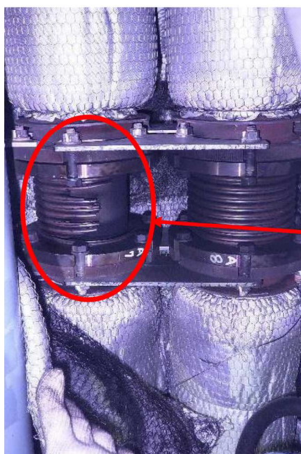
排気管伸縮継手の破損が認められた箇所
