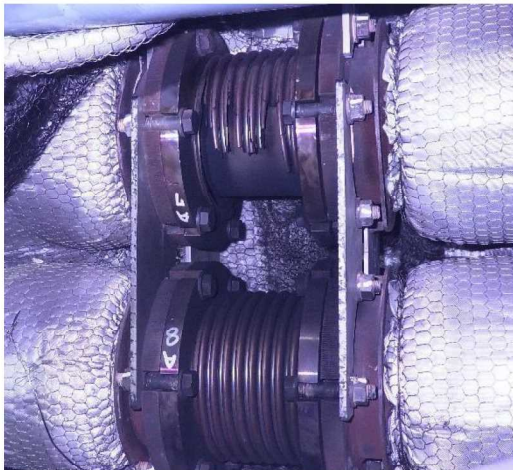
当該排気管伸縮継手
