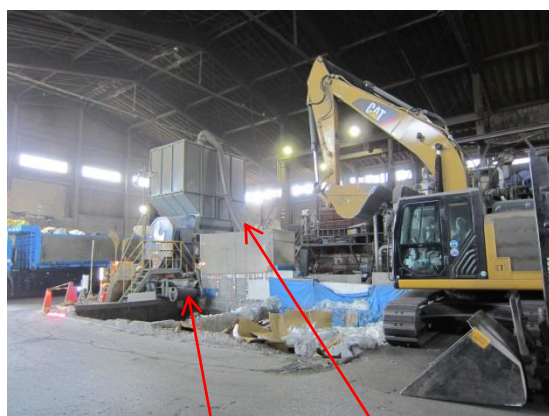
ビット前コンベア 集塵機
