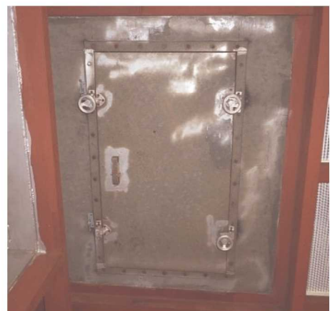
②高性能粒子フィルタ入口扉
