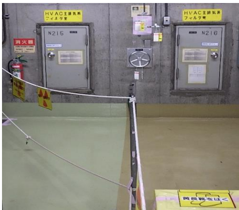
①換気系主排気ユニット (A) (B) 入口扉
