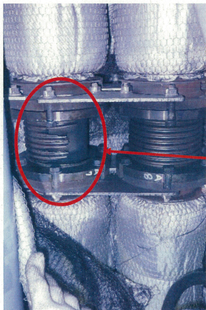
伸縮継手の破損が認められた箇所
