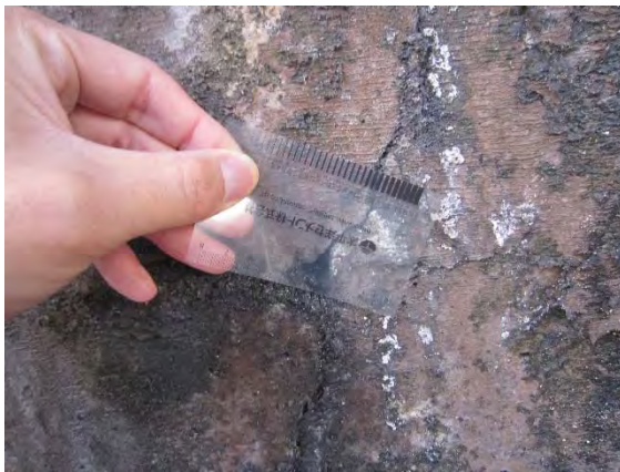
(a) 架台上部のひび割れ(1.2mm)
