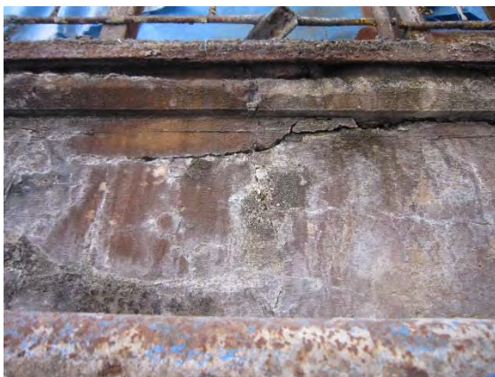
(c) 架台上縁付近のひび割れ
