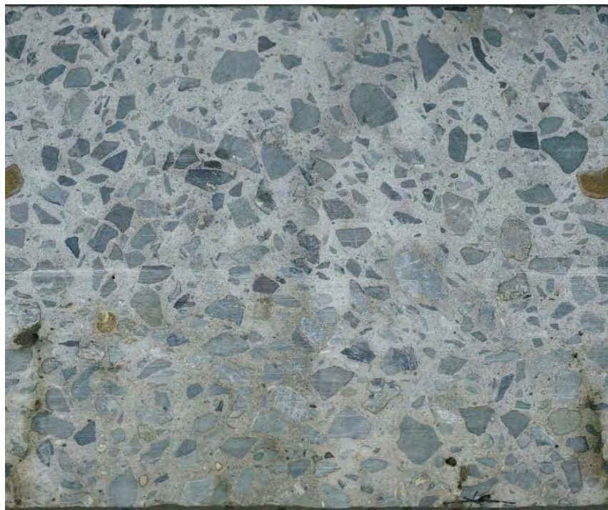
図 4.57 コンクリートコア展開写真（キルン架台上部、可視光源）
