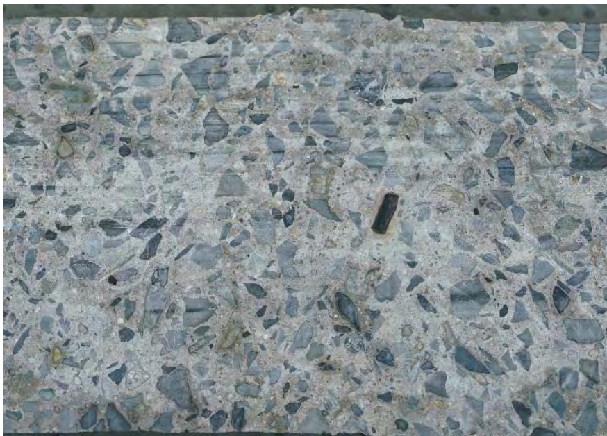
図 4.58 コンクリートコア展開写真（キルン架台下部、可視光源）
