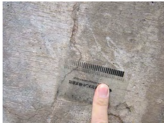
(b) 架台下部のひび割れ(0.5mm)
