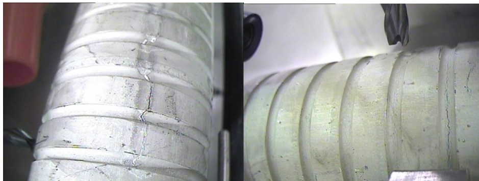
(a) 長軸方向のひび割れ
