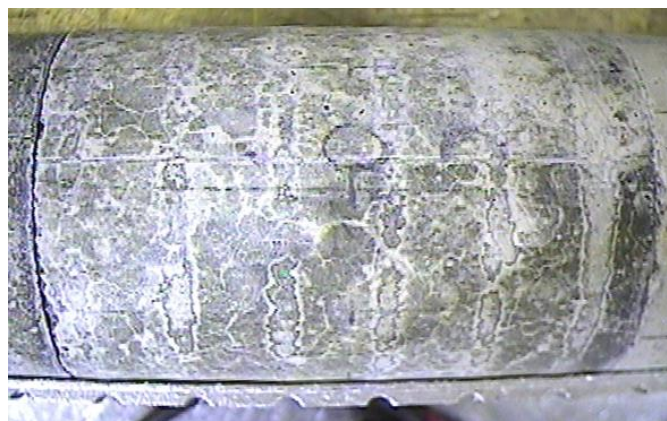
図 2.182 キャプセルに生じたひび割れ
