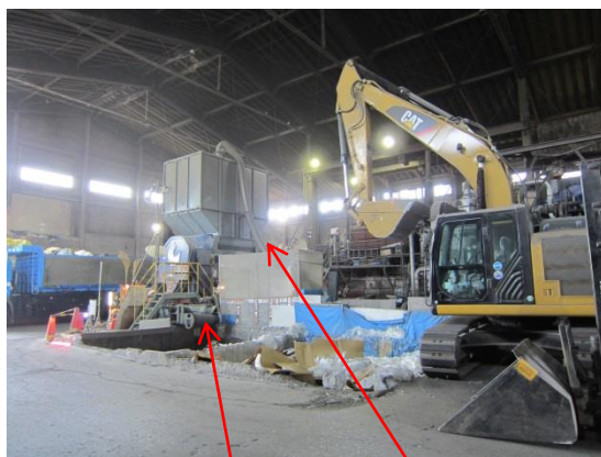
ビット前コンベア 集塵機
