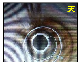
堆積物回収後 (洗浄ドレン受タンク側から確認)
