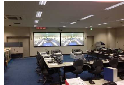
TV会議システム等通信設備
