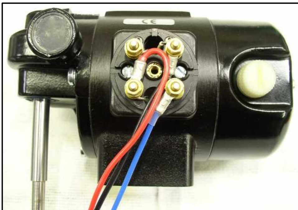
＜6号機非常用ディーゼル発電機（B）ガバナーモーター＞ （平成27年2月に新品へ交換）
