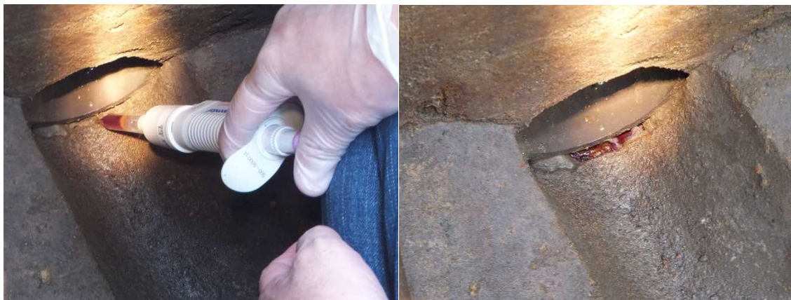
図 2：外部への浸透を確認するための隙間への着色水滴下
