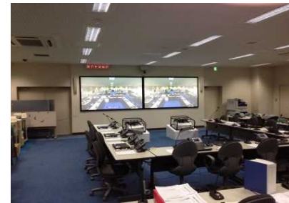
TV会議システム等通信設備
