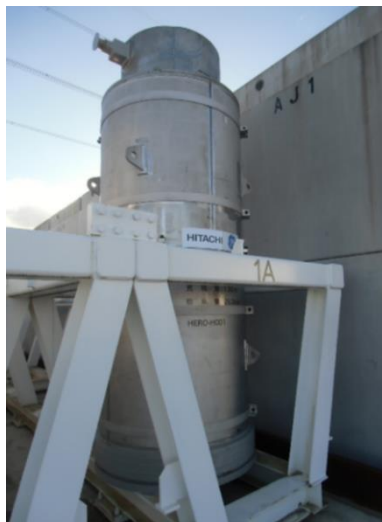
図 2.1-22 高性能多核種除去設備 多核種吸着塔保管状況
