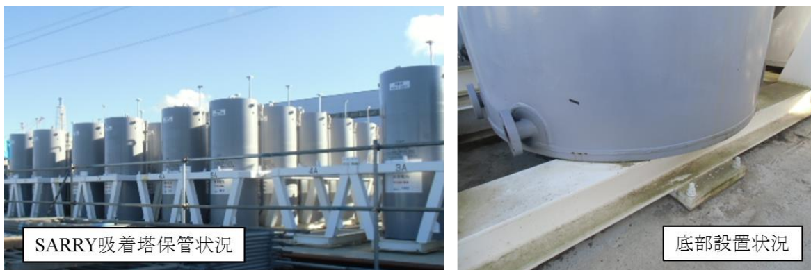
図 2.1-8 第二セシウム吸着装置（SARRY）吸着塔保管状況
