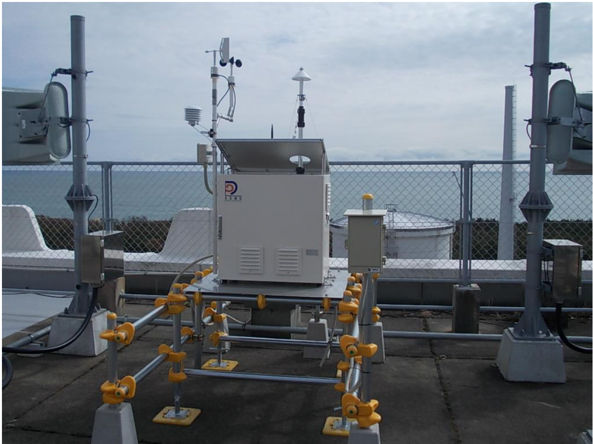
図 4.5-8 安工棟屋上に設置した増設気中塩分モニタリング装置
