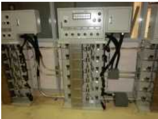
漏えい検出ユニット
