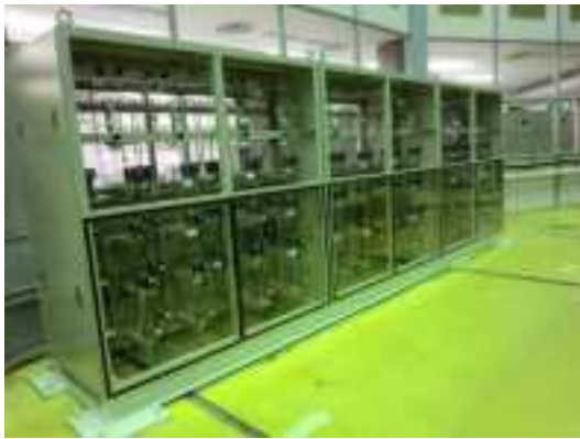
圧力制御装置部(2)
