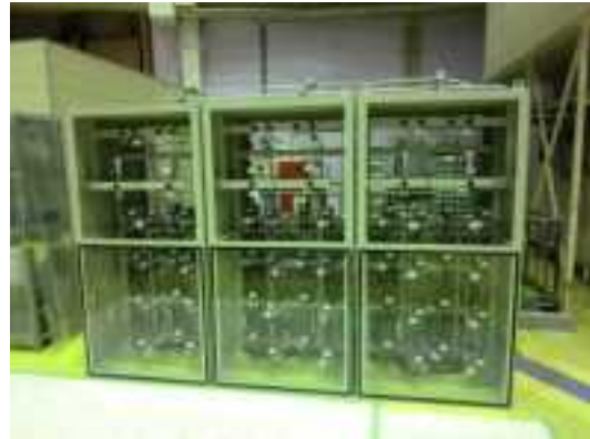
圧力制御装置部(1)
