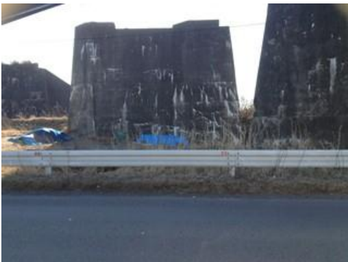
(l) 周辺構造物 G (桁が撤去された橋脚)
