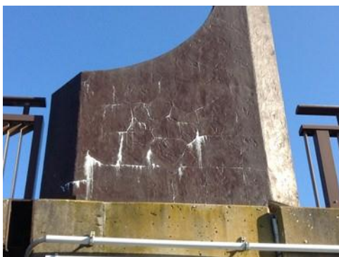
(f) 周辺構造物 B(塗装されているが内部から劣化)
