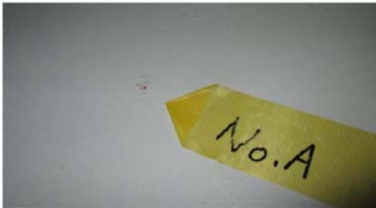
フロー②と判断した塗膜の劣化
