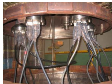
図 2 ケーブル取り付け状態
