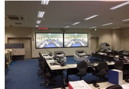
TV会議システム等通信設備
