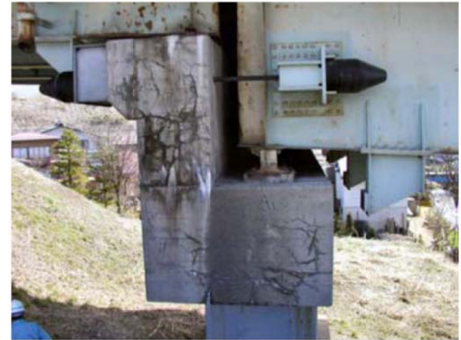
実構造物における膨張ひび割れの事例 (出典:アルカリ骨材反応による劣化を受けた道路橋の橋脚・橋台躯体に関する補修・補強ガイドライン(案) 平成20年3月 ASRIに関する対策検討委員会)
