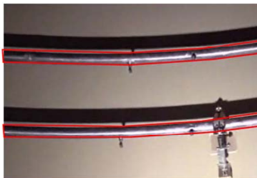
図3. 14 従来の点検で確認が容易でない範囲（内面高所の干渉物裏）
