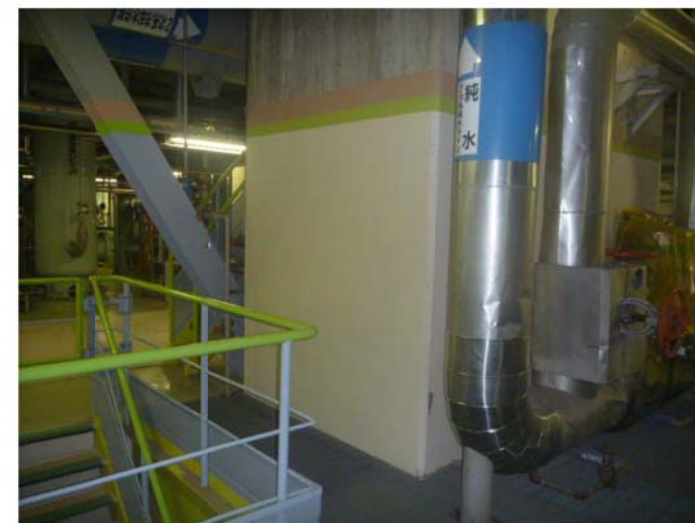
タービン架台
