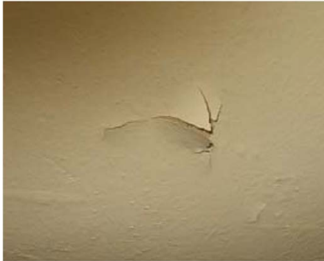
（例）中塗りが見えている塗膜状況（円筒部内面）
