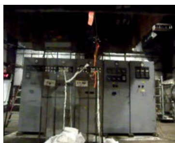
図 19 試験前の高圧電源盤
