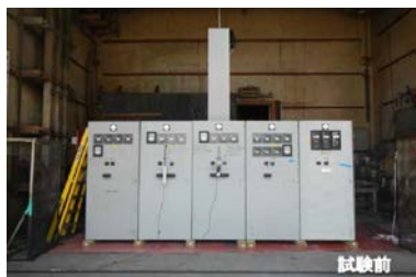
図 16. 試験前の高圧電源盤
