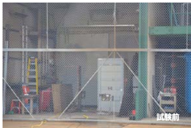
図 12. 試験前の配電盤 Fig.12 Distribution Panel before arc test
