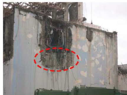
④外壁一部剥落
