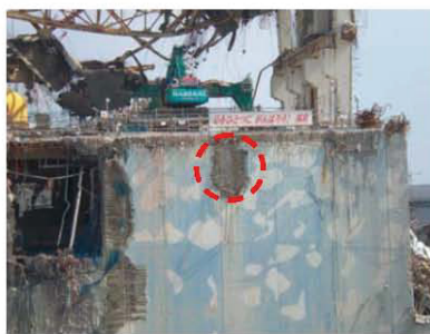
④外壁一部剥落
