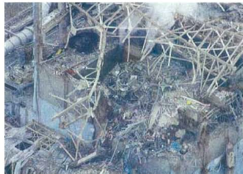
図-2.3 5階北西側の床スラブの状況
