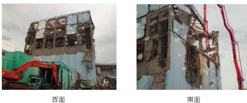
図2 西面・南面の損傷状況（5月10日撮影）
