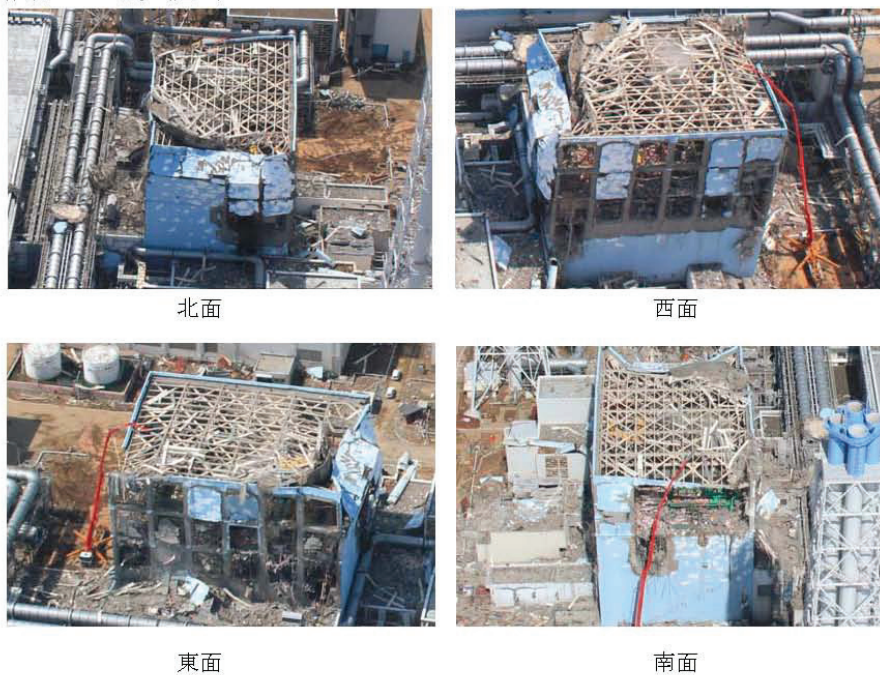
図1 損傷状況（3月24日撮影）
