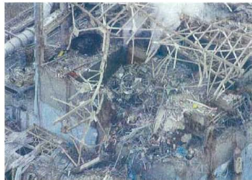
図-2.3 5階北西側の床スラブの状況
