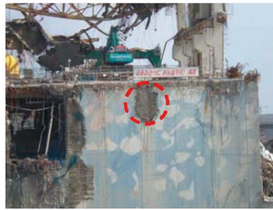
④外壁一部剥落
