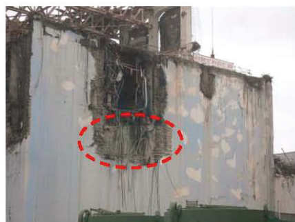
④外壁一部剥落
