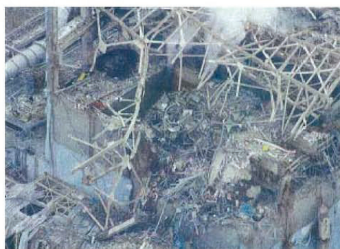
図-2.3 5階北西側の床スラブの状況
