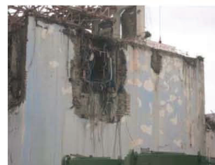
④外壁一部剥落
