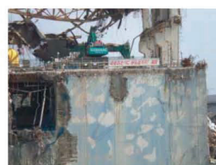
④外壁一部剥落
