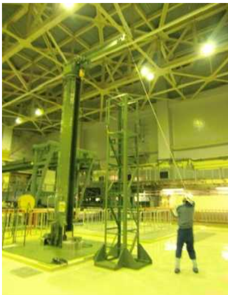
新燃料検査台
