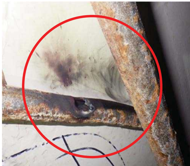
左図拡大図：電線管に穴を確認
