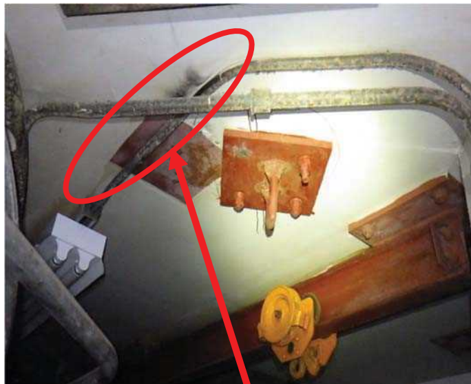
当該赤枠部分に 焦げ跡を確認
