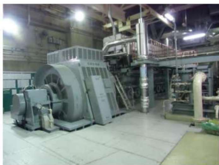
非常用ディーゼル発電機 外観写真
