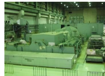
タービン・発電機
