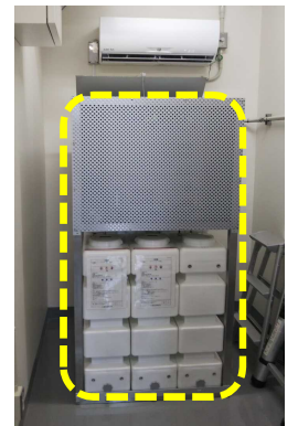
○ 非常用発電設備（燃料電池）の整備
